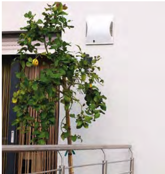
Obr. 1 - Jednotka umístěná na zdi
