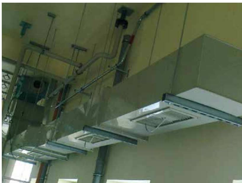
Obr. 4 - Rozvody v kyselinovzdorném provedení
