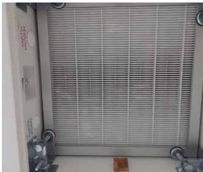
Obr. 1 - HEPA filtr instalovaný v čistém nastavci CGF připravený k testu bezdefektnosti. Pro test je sejmuta krycí mřížka - je vidět drobná poškození neodbornou montáží
