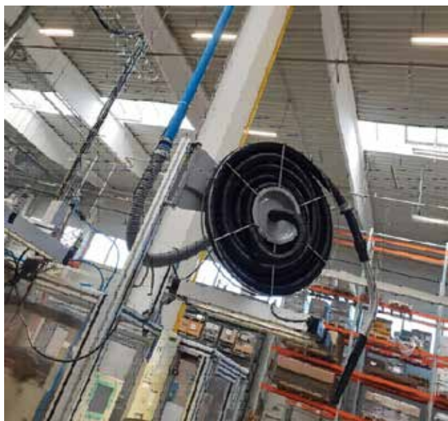
Obr. 4 - Detail dispozice NB ve výrobním prostoru
