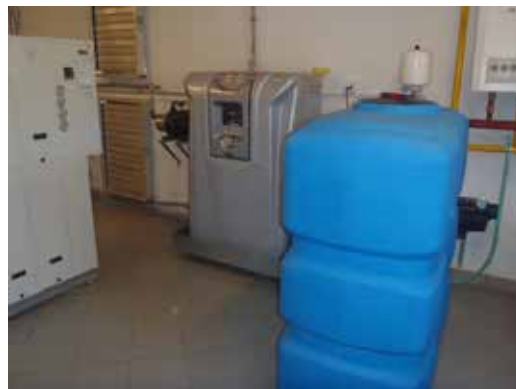
Obr. 1 - Úprava vody se zásobní nádrží
