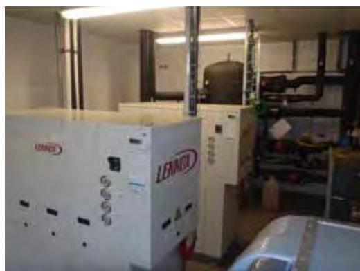
Obr. 2 - Výrobníky studené vody, vzadu vyrovnávací nádrž
