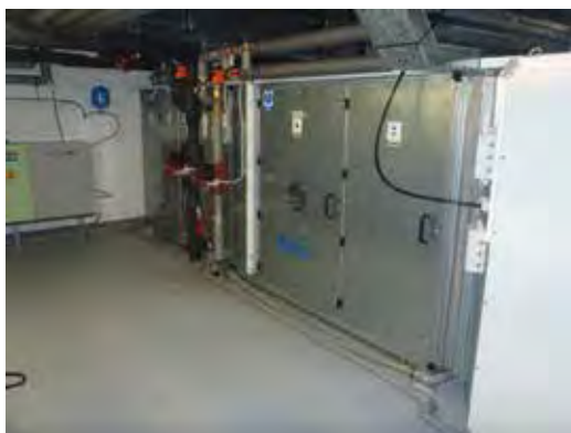
Obr. 3 - VZT jednotka, v pozadí vysokotlaká část vlhčení
