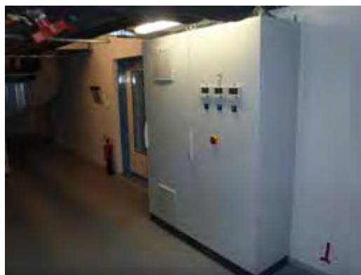
Obr. 6 - Rozvaděč MaR pro 3 VZT jednotky
