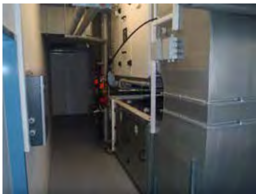
Obr. 5 - Zvlhčovací komora nad VZT jednotkou
