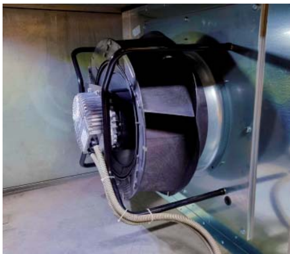
Původní a modernizovaný ventilátor
