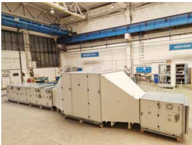
Obr. 3 – Kompletní přívodní VZT zařízení s pětistupňovou filtrací
