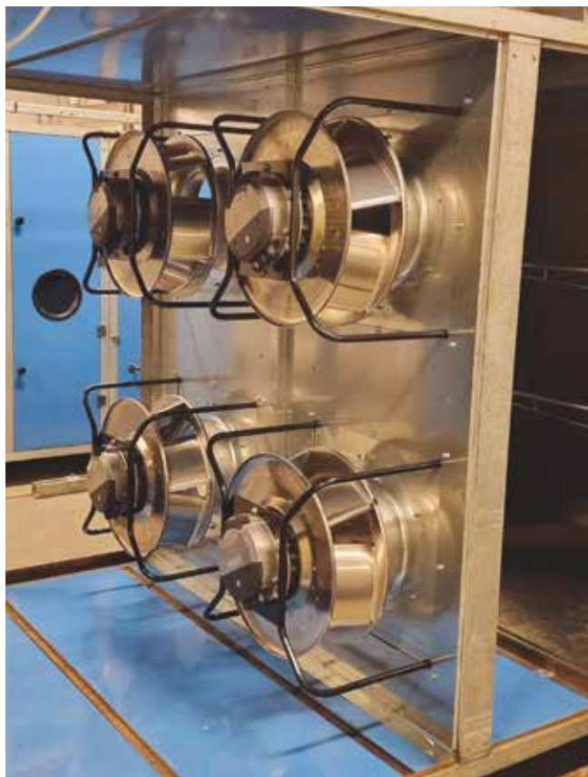
Obr. 6 – Modernizace vzduchotechnických jednotek JANKA
