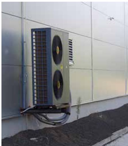
Obr. 4 – Instalace venkovní jednotky tepelné čerpadlo monoblok
