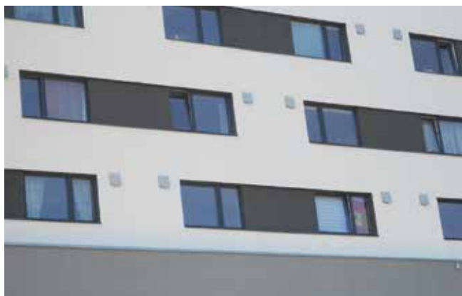
Obr. 4 – Fasáda domu s decentrálními rekuperačními jednotkami
