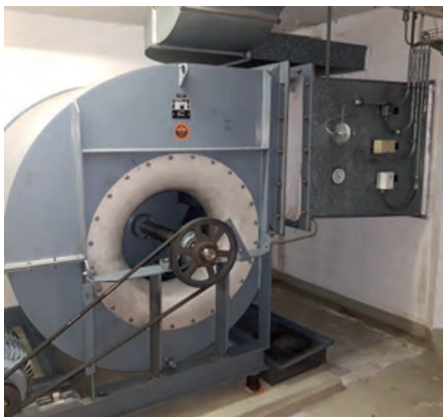
Obr. 1 – Původní ventilátor před retrofitem
