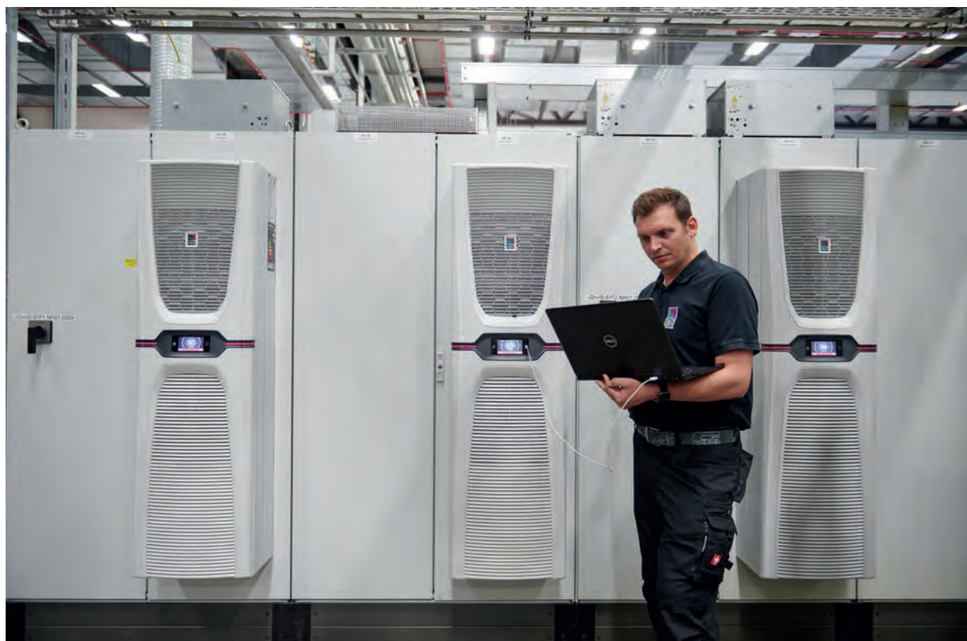
Obr. 2 – V oblasti chlazení rozváděčů je společnost Rittal dlouhodobě uznávaným specialistou na systémová řešení pro průmyslové rozváděče
