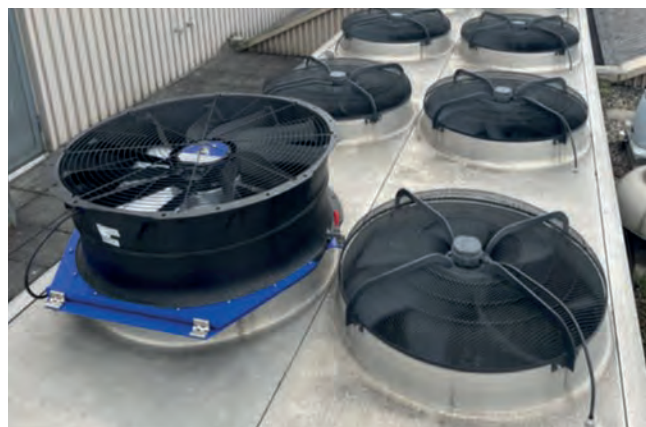
Obr. 4 – Retrofit chillerů a chladičů
