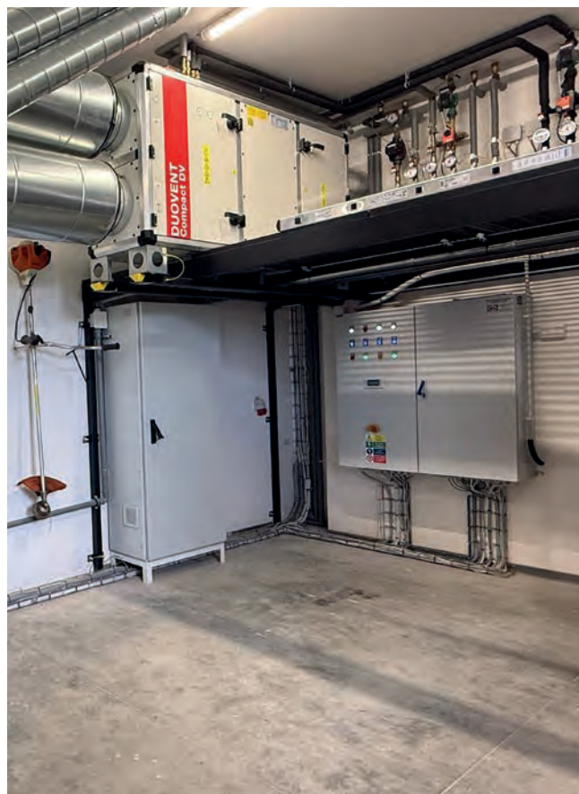
Obr. 4 – Strojovna technologického zázemí, měření a regulace dodané CIUR, a.s.
