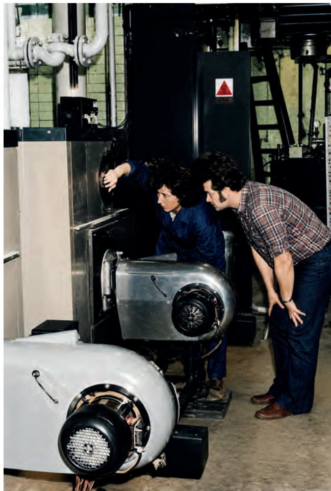
Obr. 2 – Rekonstruovaná kotelná s novými kotly a hořáky Weishaupt na lehký topný olej
