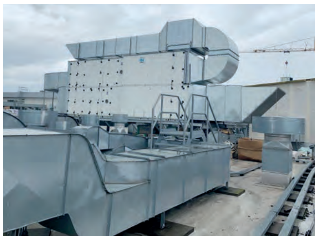
Obr. 1 – VZT jednotka JANKA Radotín na střeše objektu
