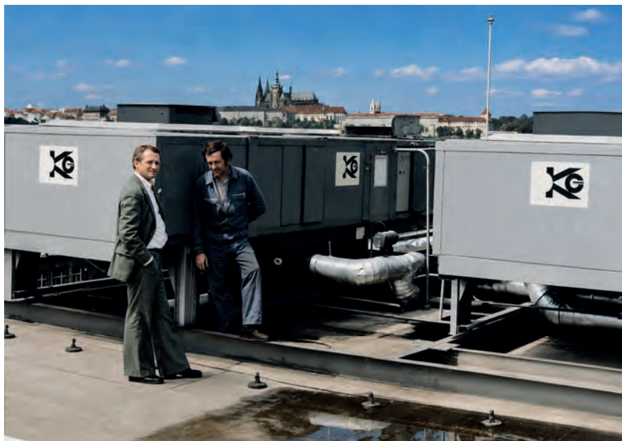
Obr. 3 – Chladicí jednotky Chrysler na střeše budovy DDK
