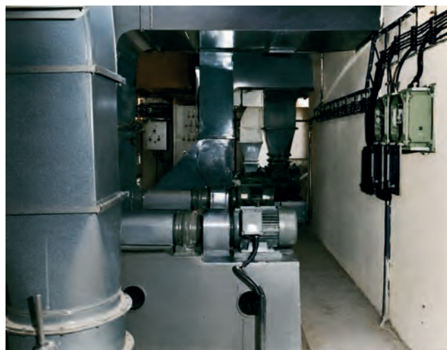
Obr. 7 – Strojovna staniční vzduchotechniky
