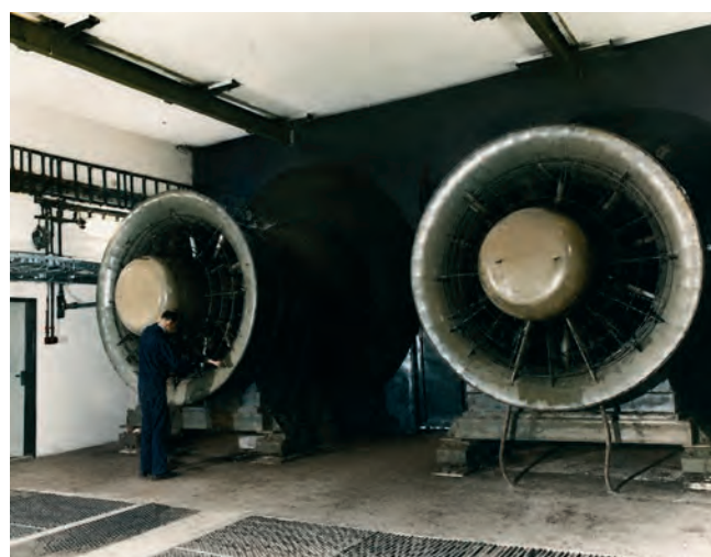
Obr. 6 – Strojovna hlavního větrání
