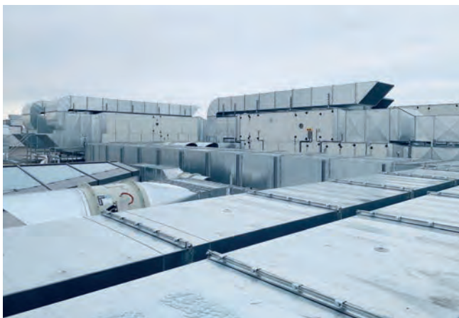
Obr. 4 – Střešní instalace vzduchotechnických jednotek
